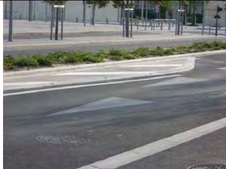
Photo (source FFMC) avant modification
